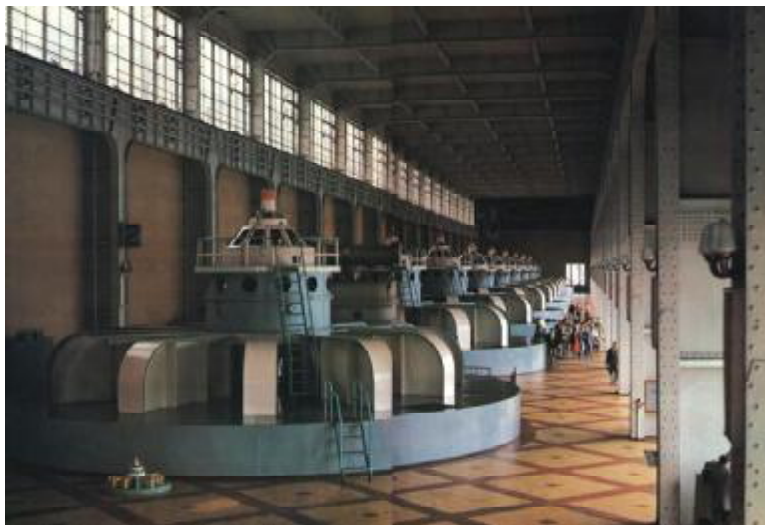
Навчальний об'єкт кафедри гідроенергетики – машзал ГЕС
